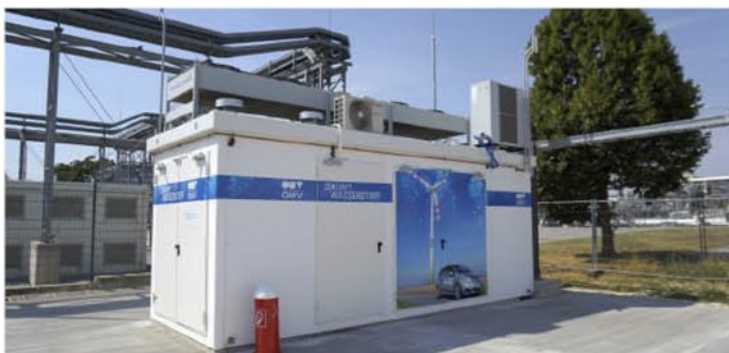
Das Projekt in Auersthal läuft bis Ende 2017, täglich wird Wasserstoff für den Betrieb von 85 Pkw hergestellt. Foto: OMV
